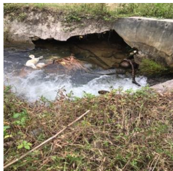
Gambar 2. Kerusakan pada dinding saluran
