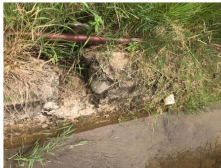
Gambar 4. Sadap liar pada bangunan irigasi
